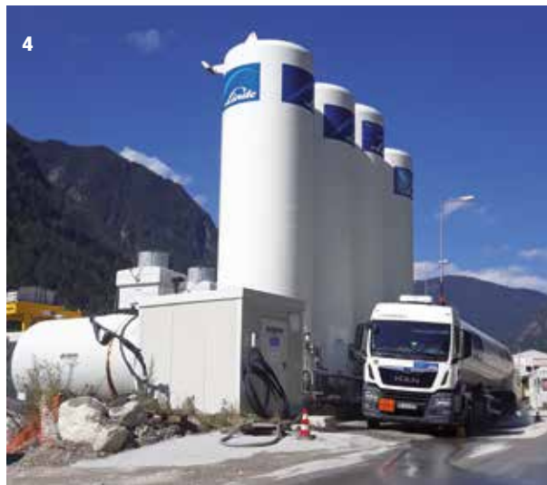
4. Impianto frigorifero di stoccaggio dell'azoto liquido
